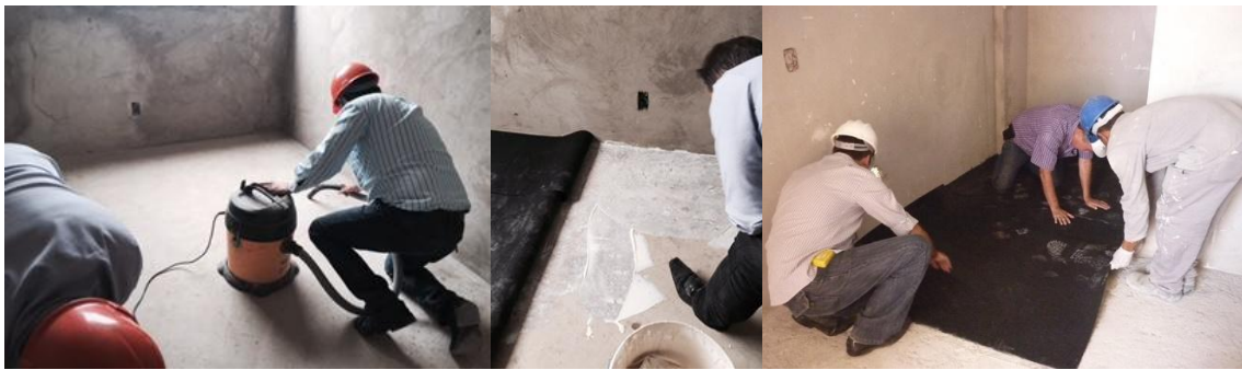
Figura 6: Limpeza da laje e aplicação de adesivo para instalação do sistema L2
